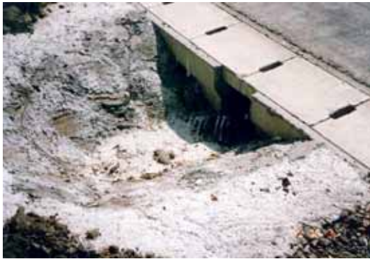
写真 - 1 0 脱出用切欠きのある側溝
